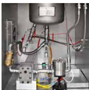
Heizbox mit Volumenzähler
